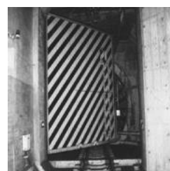
防水扉(トンネル内)
