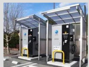
充電スタンド・蓄電池
