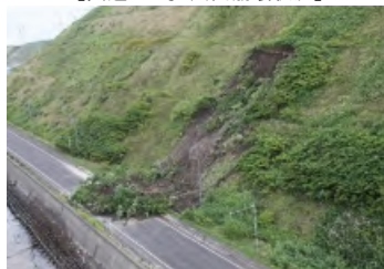
【国道232号 法面崩壊状況】
