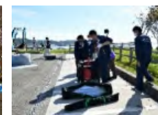
災害時を想定した発電機の稼働訓練(道の駅「厚岸グルメパーク」)
