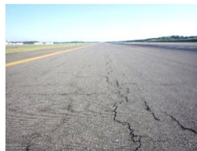
(舗装のひび割れが発生)
