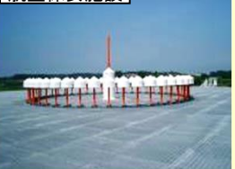
航空保安施設
