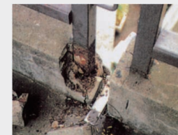
手すりの支持部の腐食
