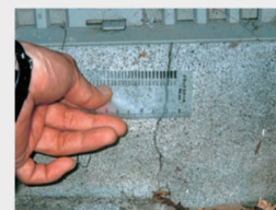
基礎のひび割れ
