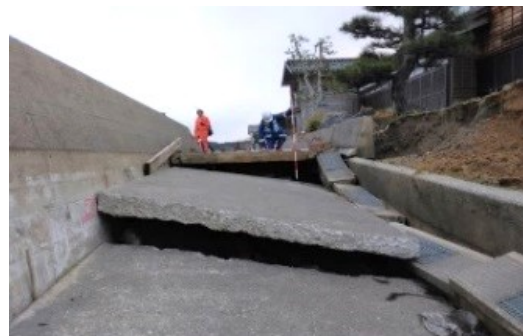
護岸・水叩き損傷
