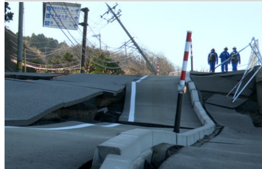
せんまいだ 国道249号道の駅千枚田付近の被害 （石川県輪島市）
