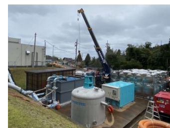
可搬式浄水施設・設備（珠洲市宝立浄水場）
