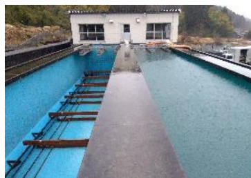
浄水場の被害（珠洲市宝立浄水場）
