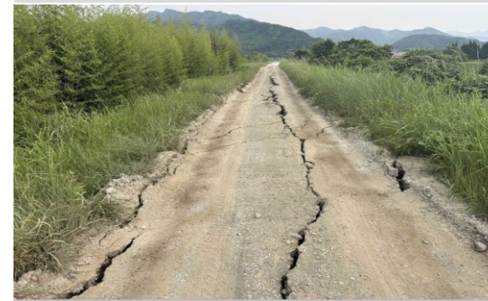
ひろとがわ ひろとがわ 広渡川水系広渡川の堤防天端の亀裂 （宮崎県日南市）
