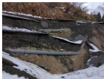
送水管の被害（輪島市）
