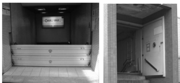
止水板・防水扉の整備
