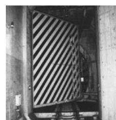
防水扉(トンネル内)
