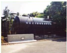
▲ 耐震性貯水槽
