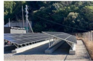
道路空間の太陽光発電設備
