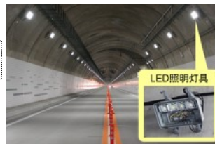
道路照明のLED化
