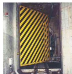
防水扉(トンネル内)
