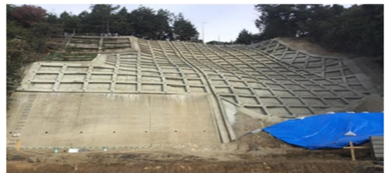
コンクリート枠による斜面の補強
