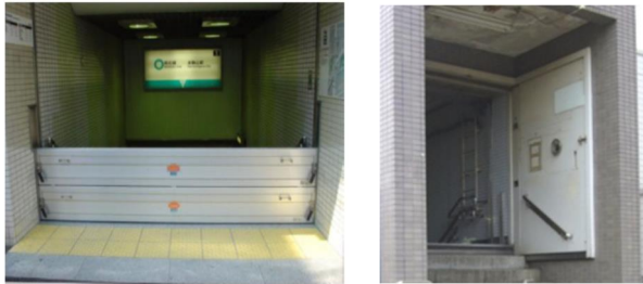
止水板・防水扉の整備
