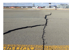
滑走路の亀裂
