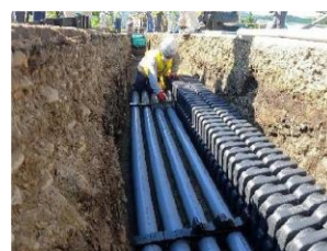
角型多条電線管の整備事例
