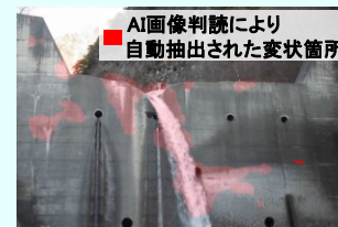
AIを活用した砂防堰堤の変状確認
