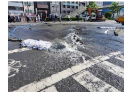
老朽化による漏水事故の例
