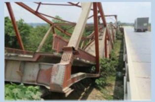
落橋事例（令和7年10月、フィリピン）
