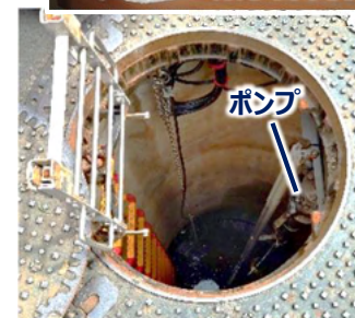
液状化対策施設の例 (千葉県千葉市)
