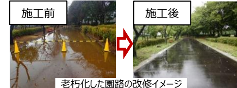
老朽化した園路の改修イメージ
