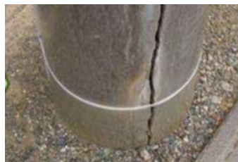
外部要因により発生した劣化が経年により進行
