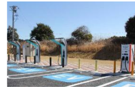
EV充電施設
