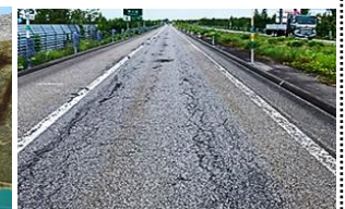
アスファルト路盤の損傷
