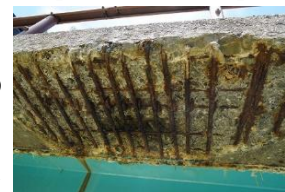
床版鉄筋の露出
