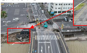
国道10号 令和7年8月の大雨 (鹿児島県始良市 網掛橋)
