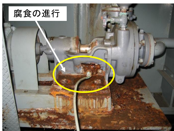
排水設備の劣化
