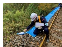
路盤の流出状況の 測定
