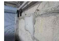
校舎等のひび割れや剥離
