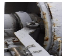
甲板上設備の発錆
