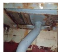
衛生設備及び付帯配管の腐食
