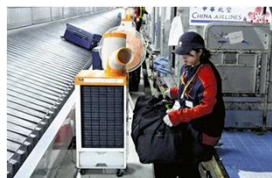
ソーティングエリアに設置された スポットクーラー
