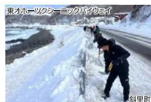
【秀逸な道】 一面の流氷が織りなすクレーンチャックを体感する道 ガードレール除雪
