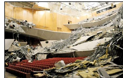
東日本大震災(平成23年)における 天井脱落の例
