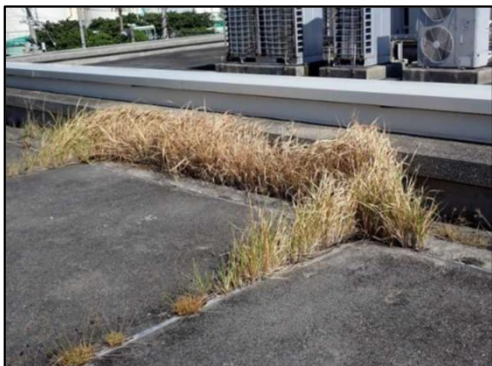
屋上目地部の雑草
