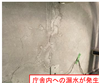
庁舎内への漏水が発生
