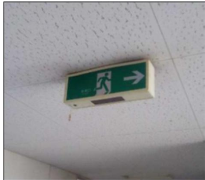
点灯しない誘導灯
