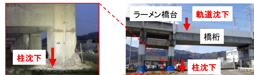
令和4年3月の地震による被害
