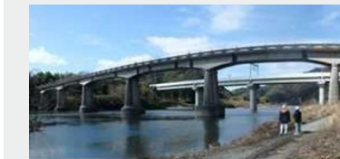
老朽化した橋梁（写真：国交省資料より）
