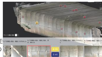
インフラの破損箇所の自動記録
