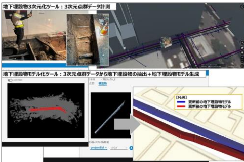
実際に更新作業を行っている際に 管路を上から撮影し、3D化をしている
