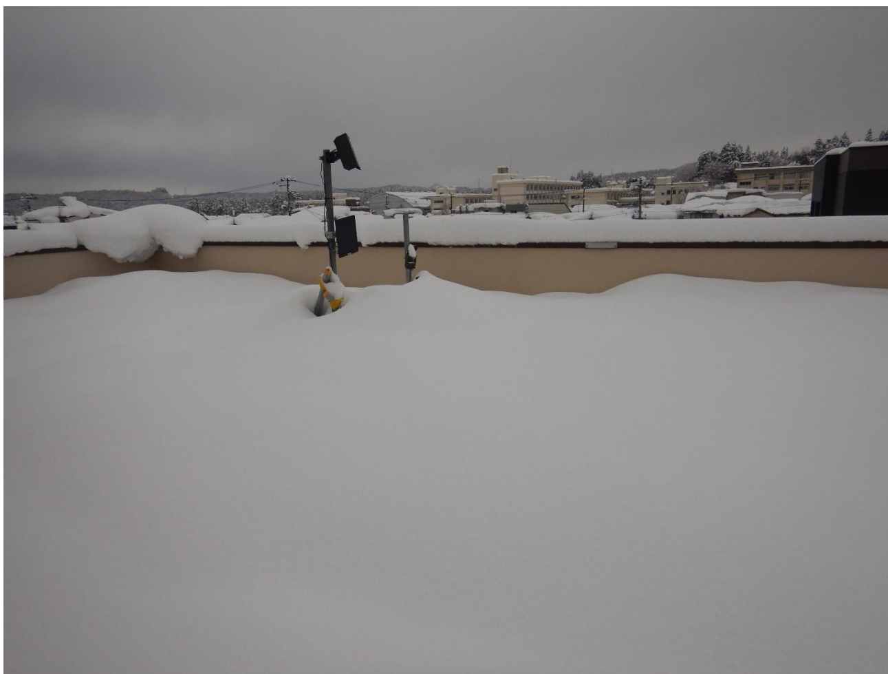
図 9-11 データ提供対象建物の屋根上の積雪状況 (1 月 29 日 長岡市役所栃尾支所)
