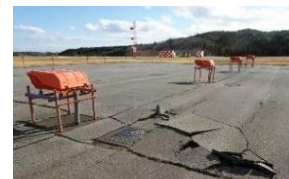
能登空港の被災状況
