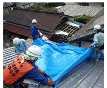
ブルーシートの設置状況（千葉県山武郡芝山町）
