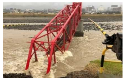
千曲川橋梁崩落状況（長野県長野市）
