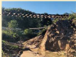
三陸鉄道 道床の流失
