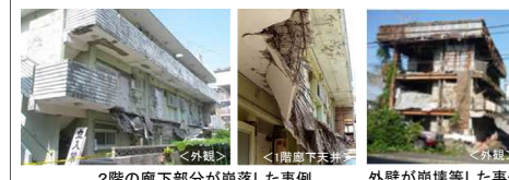
2階の廊下部分が崩落した事例 <左> 1階廊下天井が剥がれた事例 <中> 外壁が崩壊等した事例 <右>
