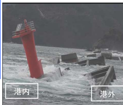
釜石港の湾口防波堤被災状況
