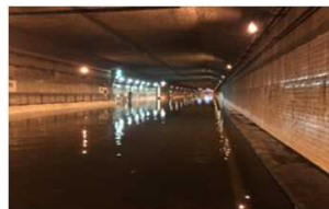
トンネルの冠水状況 (神戸港)
