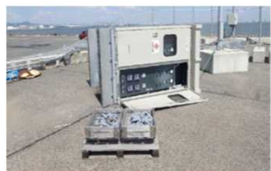
電気設備の被害 (神戸港)
