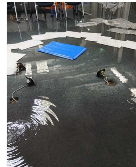
北部事務所 浸水状況
