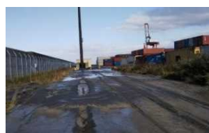
コンテナターミナルの液状化 (苫小牧港)
