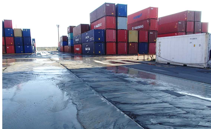
コンテナヤードの液状化
