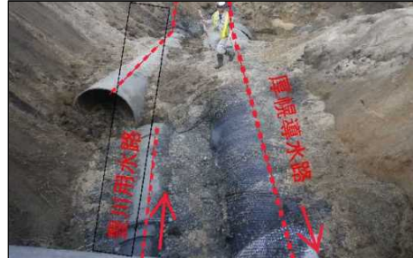
【勇払東部地区】厚幌導水路等 管水路の離脱・漏水
