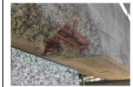
損傷状況(鉄筋露出)
