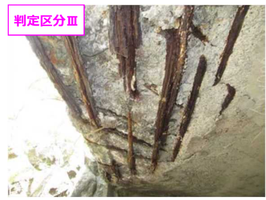
床版鉄筋露出 ※床版:橋の裏側
