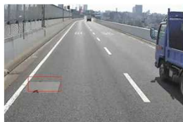
路面損傷の検知
