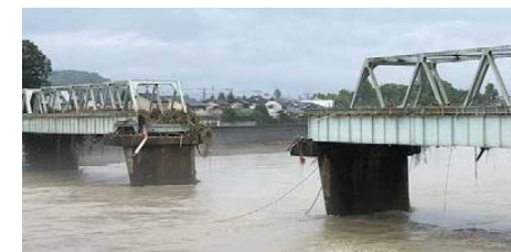
橋梁損壊状況把握
