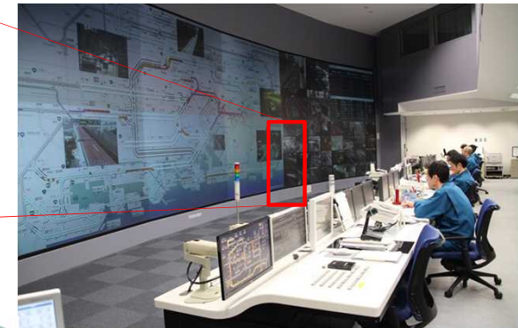
交通管制室（首都高に3箇所）
