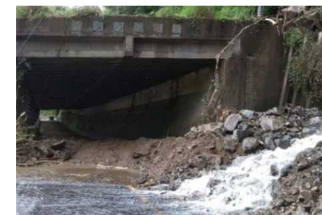
護岸損壊状況把握
