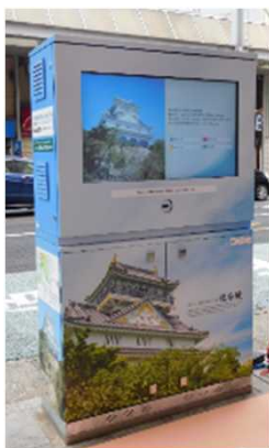
<路上変圧器を活用した事例>
