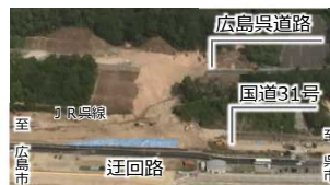
広島県道路・国道31号の被害状況
