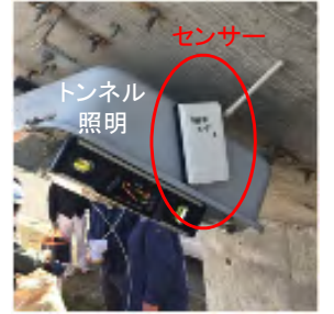
トンネル内附属物の異常監視センサー
