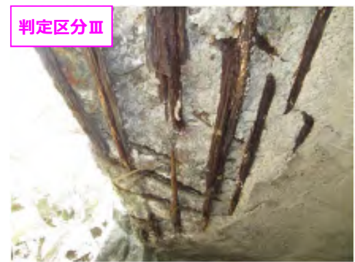
床版鉄筋露出 ※床版:橋の裏側
