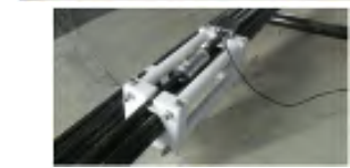
センサーによる橋梁ケーブル張力のモニタリング
