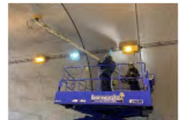
レーダーを利用したトンネル覆工の損傷把握
