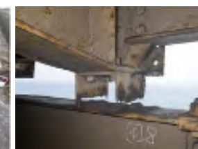
▲シェッド主梁端部破断
