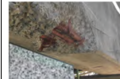
損傷状況(鉄筋露出)
