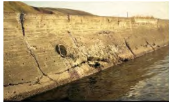
堤防の表法被覆工が損傷
