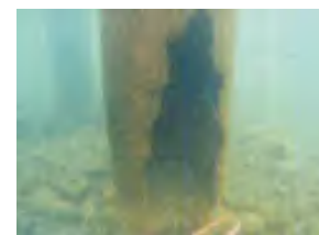
▲橋脚水中部の断面欠損
