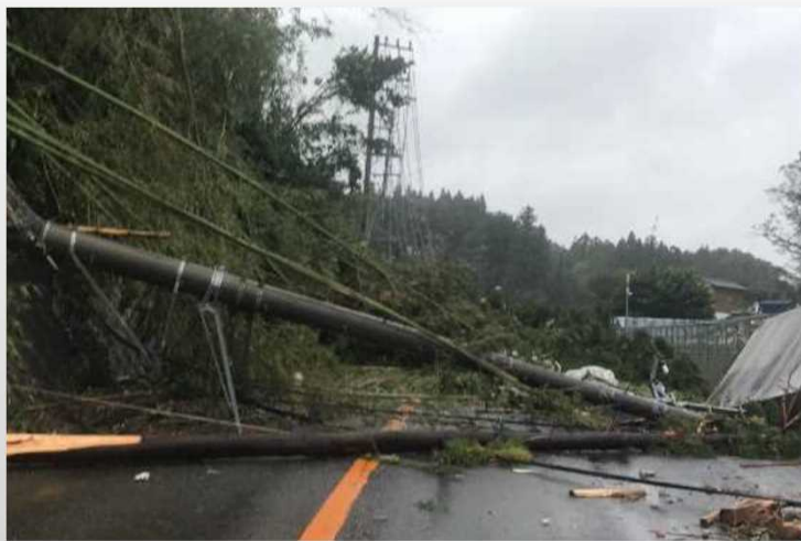
竜巻と推定される突風による被害状況（市原市）
