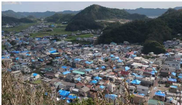
暴風による屋根の被害状況（鋸南町）
