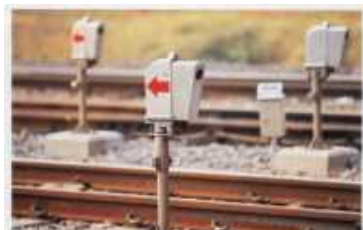
踏切支障報知装置
