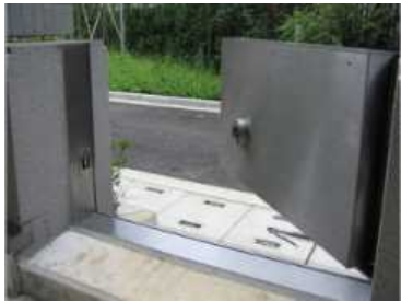
<整備例> 防水扉(金町浄水場)
