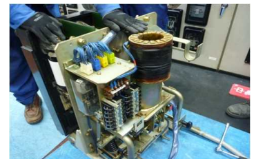
電気設備の焼損状況
