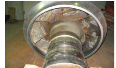
ポンプ羽根車の壊食状況
