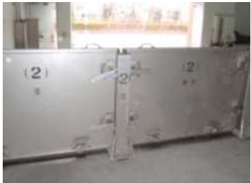
止水板(葛西給水所)
