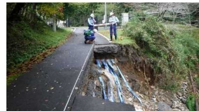
栃木県栃木市の被災状況調査(R1.10.18)
