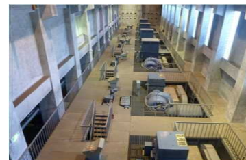
老朽化した横芝揚水機場
