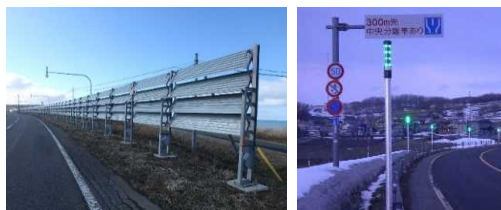
防雪柵の整備
