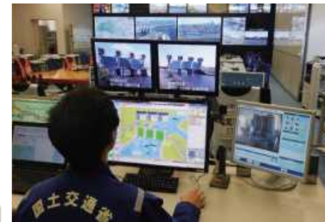
事務所等からモニターを見ながら施設操作
