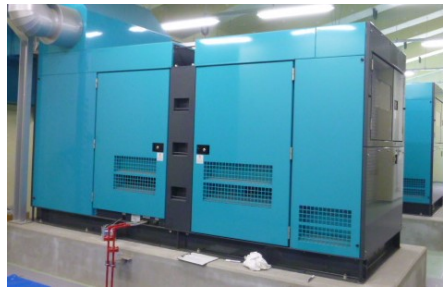
電源設備 (パッケージ型発動発電機)
