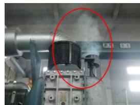
白煙発生状況
