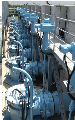
主ポンプ設備 (コラム式水中モータポンプ)
