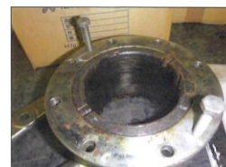
ポンプ軸受内径側に摩耗痕
