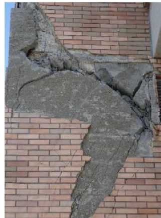
壁の損傷外観
