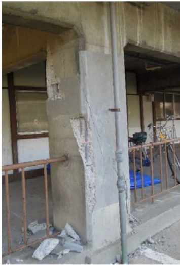
ピロティ柱のせん断破壊
