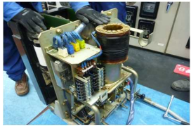
電気設備の焼損状況
