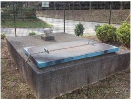
神崎町水道 古原浄水場水源1号井
