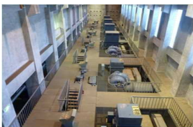
老朽化した横芝揚水機場
