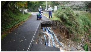
栃木県栃木市の被災状況調査(R1.10.18) 提供：関東地方整備局
