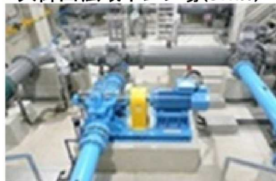
久御山広域ポンプ場(31kW)
