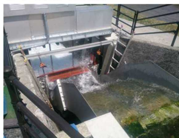
小水力発電施設
