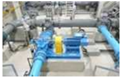
久御山広域ポンプ場(31kW)
