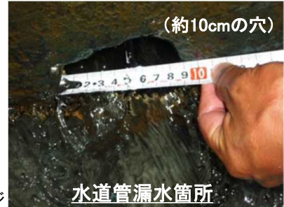
水道管漏水事故状況
