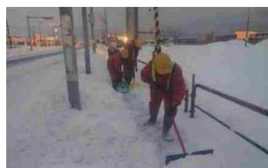
電柱により歩道が狭い箇所は人力で 除雪するため作業効率が低下 （苫小牧市 国道36号）
