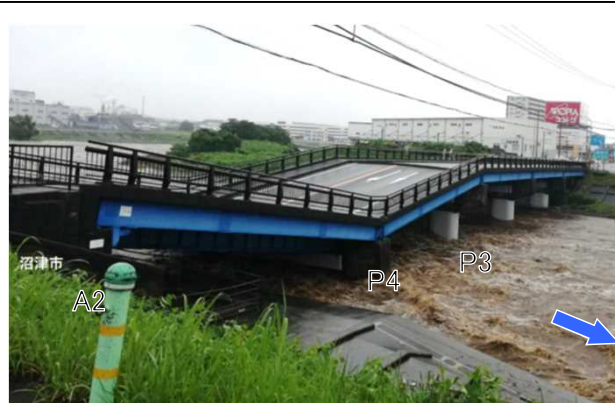
P4橋脚の沈下・傾斜
