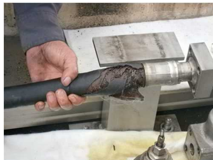
油圧シリンダ式開閉装置 油圧配管 フレキの破損（漏油）
