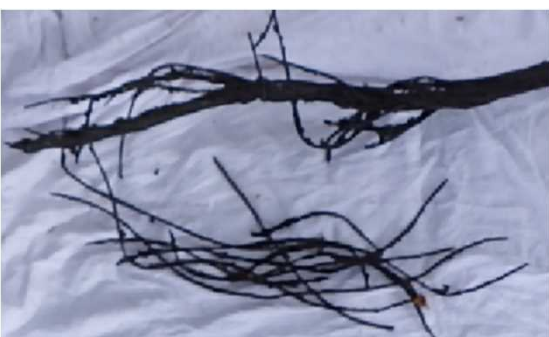
ワイヤロープの腐食による素線の減肉によりワイヤロープを構成する素線が切れ、散乱
